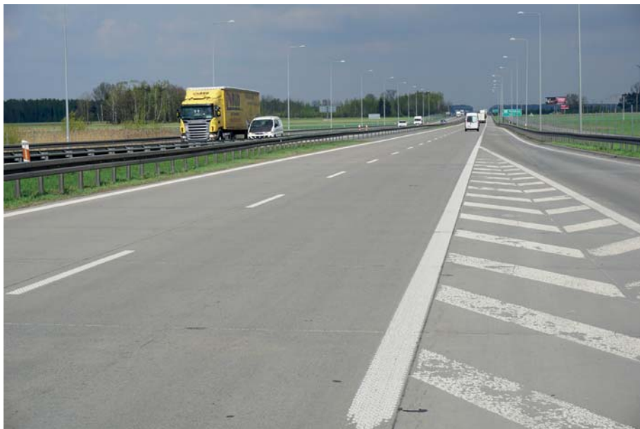
Rys. 1.3. Widok odcinka nawierzchni betonowej na drodze krajowej po 15 latach eksploatacji
